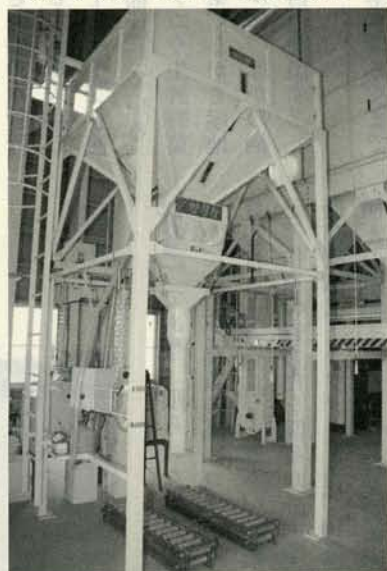
▲フレコン計量ユニットSFK-1000Sを前面に設置し、調製が終了したコメを貯留するタンクも乾燥機の前に設置している
